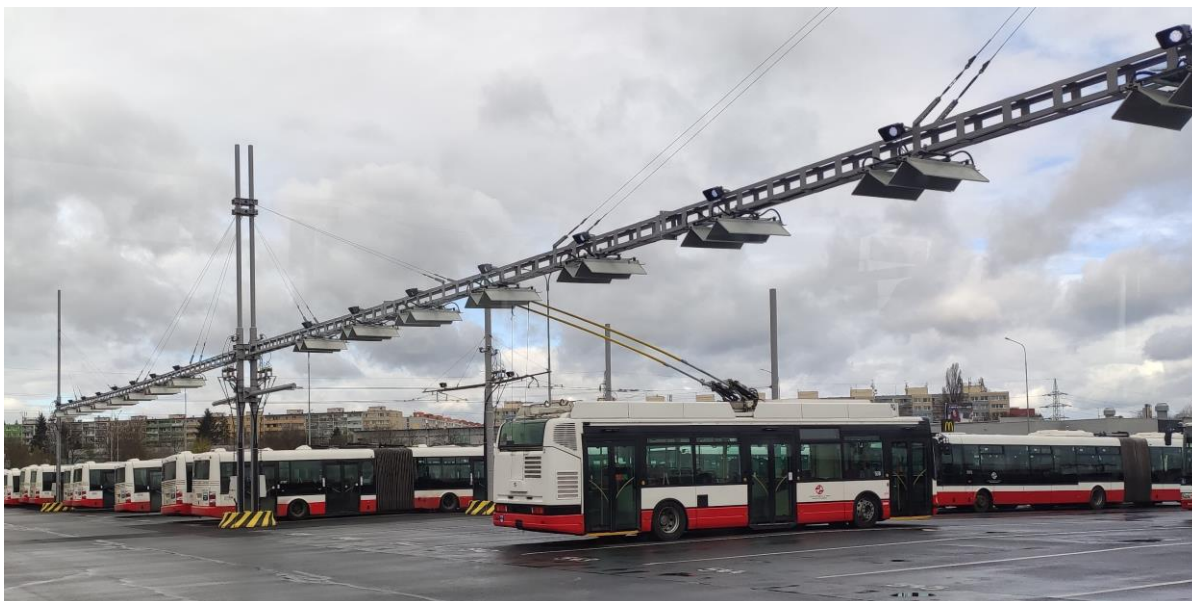
Obr. 3 – Dobíjecí základna parciálních trolejbusů v garážích Klíčov (© Jaroslav Rak)
